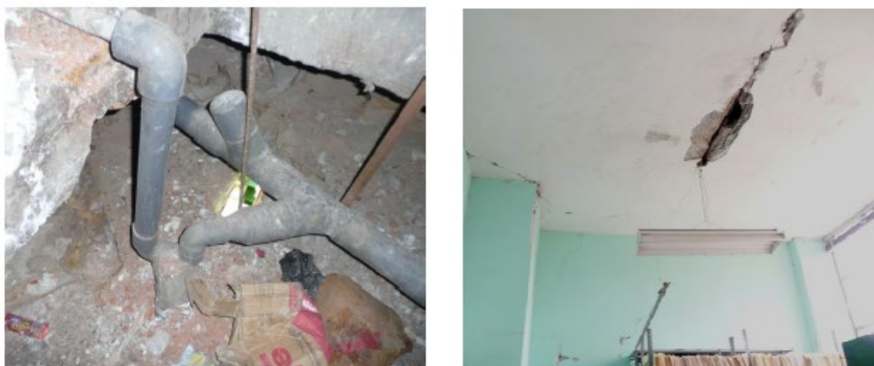
Figura 3. Tuberías y Falso cielo en riesgo de colapso, Pabellón C (Fuente: Resumen Ejecutivo, Estudio de Vulnerabilidad estructural sísmica estructural y no estructural del Hospital Hipólito Unanue de Tacna, CISMID, 2010).
