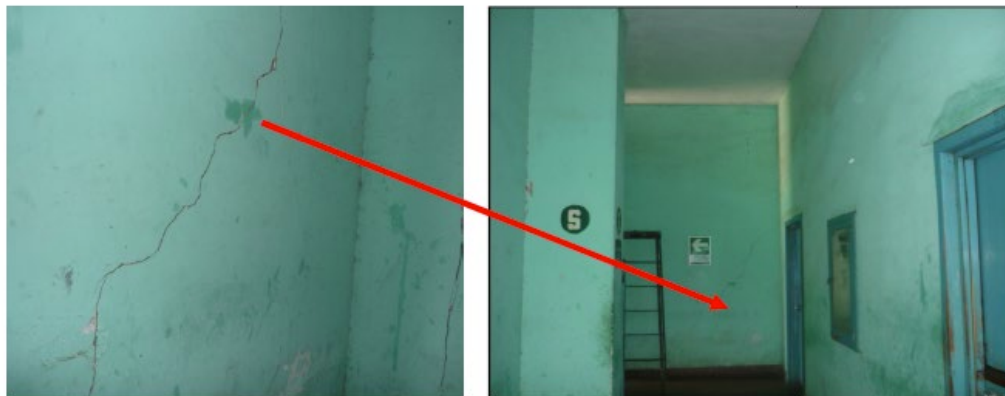
Figura 2. Grietas en zona de pasillo, Pabellón A (Fuente: Resumen Ejecutivo, Estudio de Vulnerabilidad estructural sísmica estructural y no estructural del Hospital Hipólito Unanue de Tacna, CISMID, 2010).
