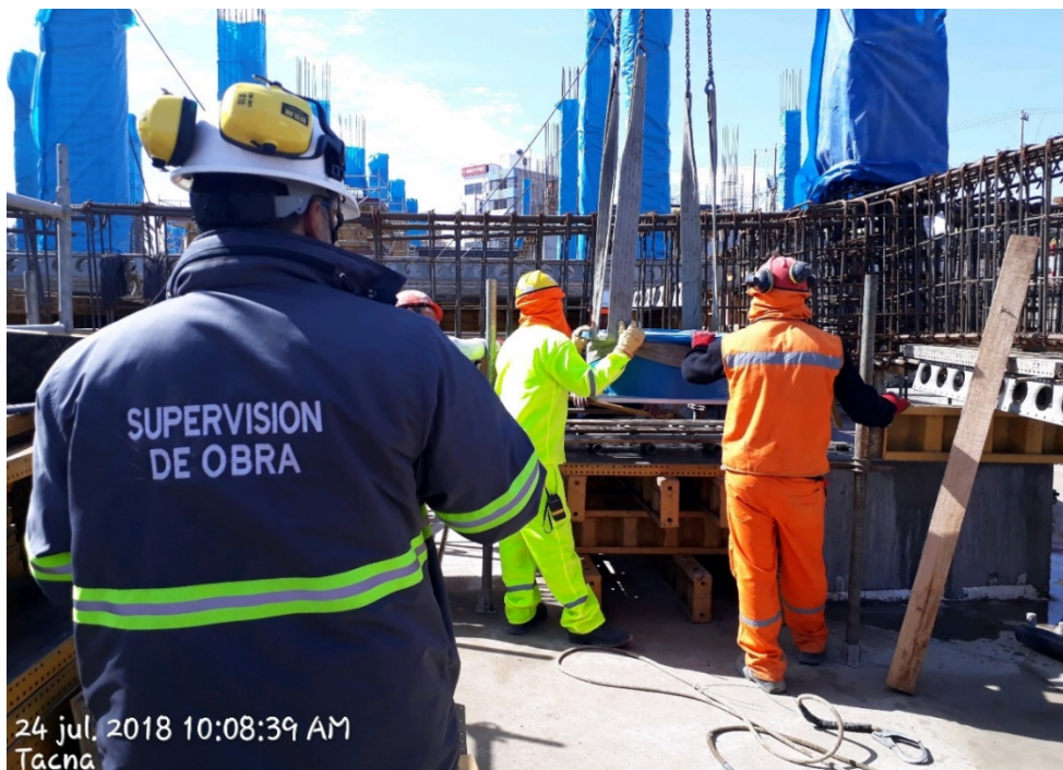
Foto 33. Colocación de aislador sísmico sobre pedestal (Fuente: Consorcio Hospital Tacna - Hospital Hipólito Unanue de Tacna, 2018).
