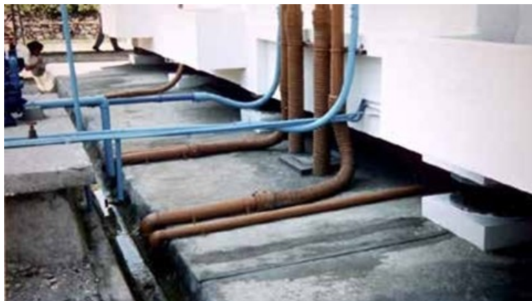
Figura 16. Tuberías y dispositivos flexibles para permitir los movimientos propios de los edificios con aislamiento sísmico. (Fuente: Geniatus & Lafuente, 2016).
