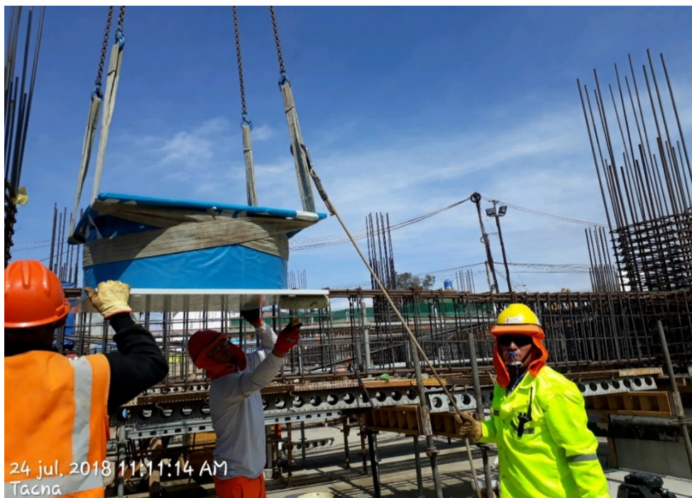
Foto 32. Vista emplazamiento de aislador sísmico con grúa transportadora. (Fuente: Consorcio Hospital Tacna - Hospital Hipólito Unanue de Tacna, 2018).
