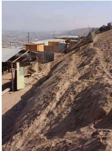
Figura 40: Potencial zona de derrumbe a expensas del depósito Tecnógeno.
