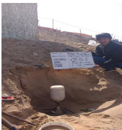
Figura 44: Perfil estratigráfico de la calicata N° 02 clasificado como un suelo areno limoso (SM).Se observa la prueba de densidad de campo.
