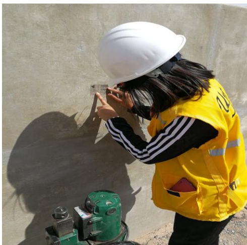
Figura N°09: Registro de fisura en el exterior de la infraestructura de la bocatoma
