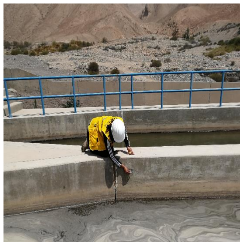
Figura N° 10: Registro de fisura en la loza de bocatoma.
