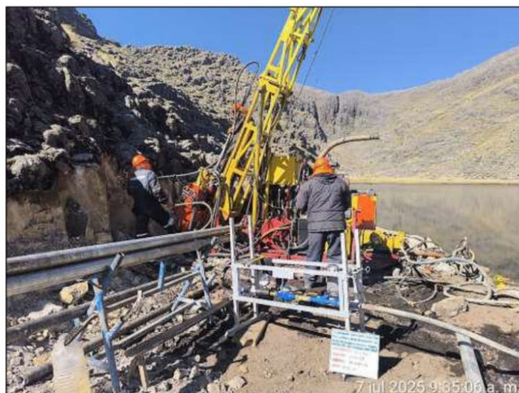
Fotografía N° 20: Vista Panorámica de Instalación e inflado de paker para realizar la prueba de permeabilidad Lugeon.
