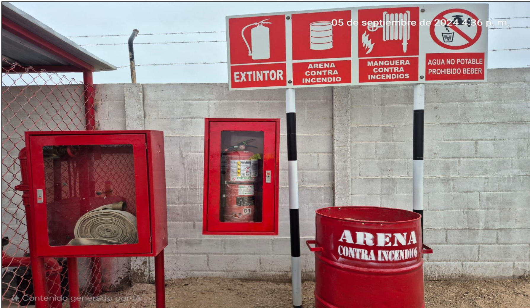
Anexo 24. Equipos de emergencia en caso de incendios
