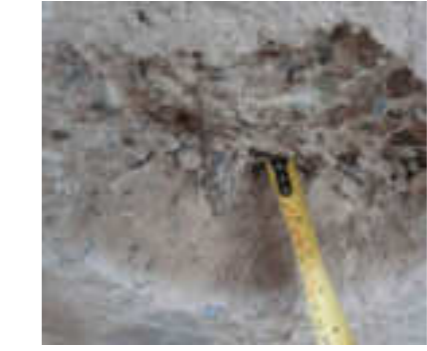
En la imagen se evidencia la presencia de cangrejeras en la parte inferior del muro C, con exposición del acero de refuerzo.
