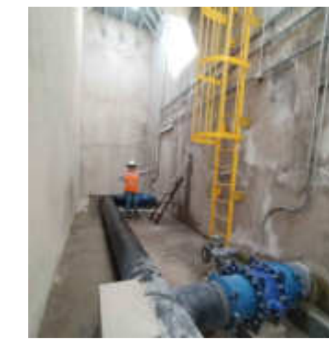
Se evidencian patologías en la cara exterior del muro B de los sedimentadores 3 y 4, correspondiente a la zona donde se realizó la extracción de muestras mediante núcleo diamantado.
