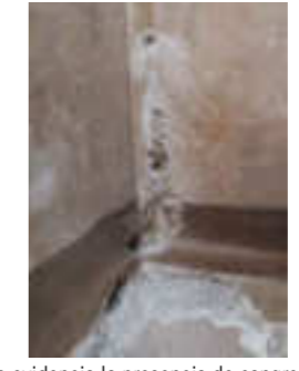
Se evidencia la presencia de cangrejas en la parte inferior del muro B, con una profundidad aproximada de 15 cm y un ancho de 25 cm.
