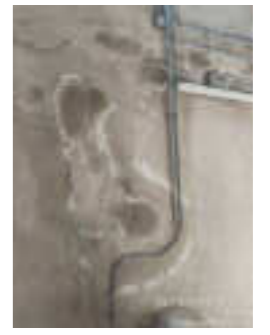
Se evidencia la presencia de humedad en la cara exterior del muro B.
