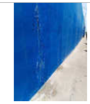
Se evidencia la presencia de filtración de agua a través de fisuras verticales localizadas en la cara exterior del muro A.
