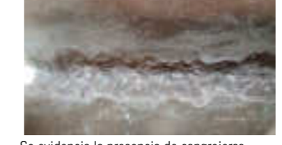
Se evidencia la presencia de cangrejas en la parte inferior del muro B, con una profundidad aproximada de 15 cm y un ancho de 25 cm.
