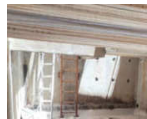
En la imagen se evidencia la presencia de cangrejeras en la parte inferior del muro B, así como el desprendimiento del sellado de los obturadores de estanqueidad.
