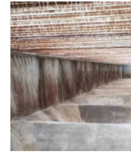
En la imagen se observa la presencia de fisuras verticales en el muro A, así como humedad asociada a dichas fisuras.
