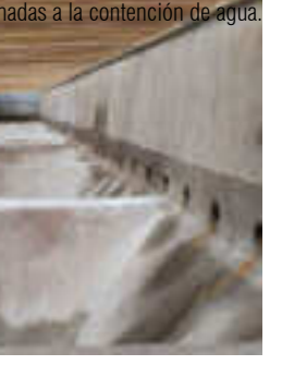
Se evidencia la presencia de fisuras verticales en la cara del muro C, así como humedad en dicho muro. Asimismo, se observan fisuras y presencia de humedad en las tolvas.
