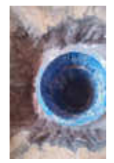
Se observa desprendimiento de concreto en el contorno del tubo de succión de lodos, con una profundidad aproximada de 10 cm.
