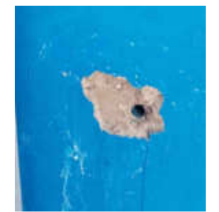
En la fotografía se evidencia el desprendimiento del sellado del obturador de estanqueidad, asimismo, se observa la ausencia de la roseta de estanqueidad, elemento necesario en estructuras destinadas a la contención de agua.
