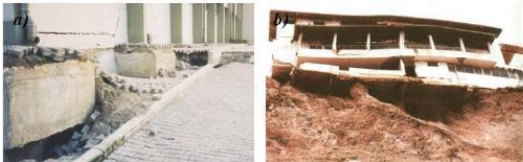
a) Licuación del suelo b) Deslizamientos del suelo
