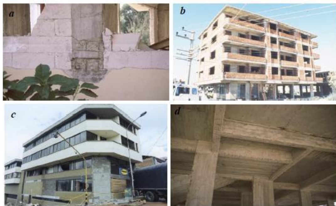
a) Mala calidad en la construcción b) Irregularidades verticales, piso blanco; c) Irregularidades en planta d) Mala configuración estructural
