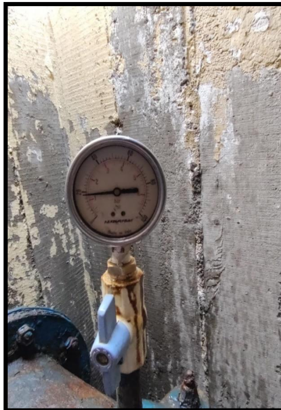
Toma de presión de agua de la cámara reductora de presión de la Av. Ejercito
