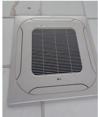
Aire acondicionado tipo cassette de techo
