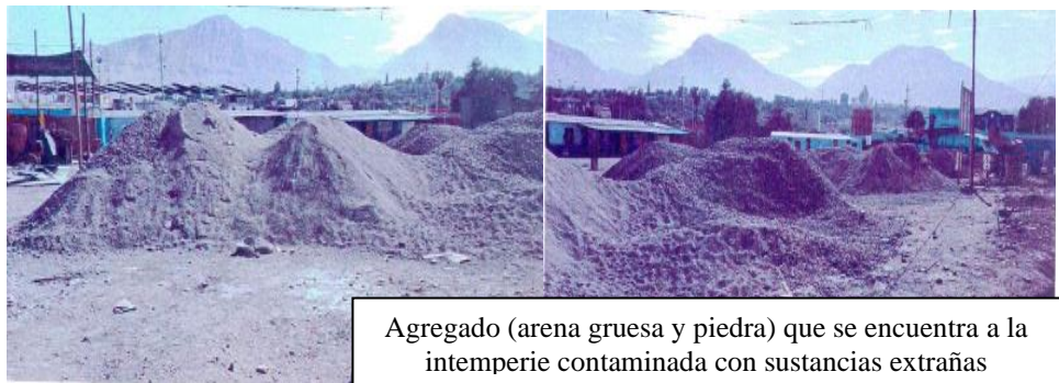
Figura 7 Almacenamiento inadecuado de agregados
