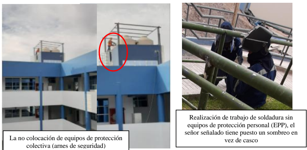
Figura 8 La no colocación de equipos de protección colectiva
