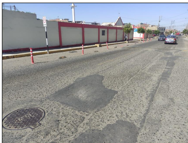
Fotografía 2. Evidencia del mal estado de la carpeta asfáltica en la avenida Tarata.
