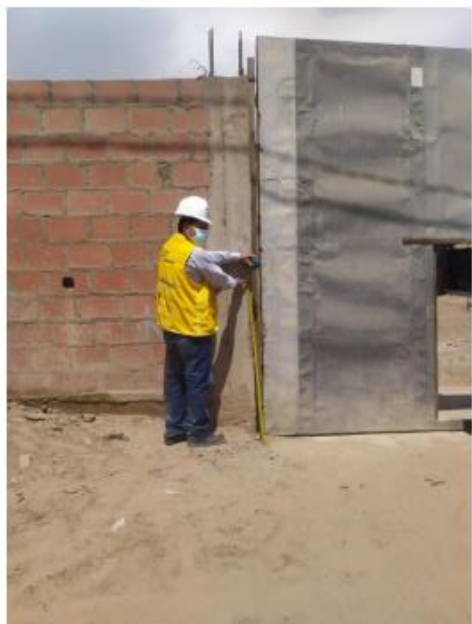
FOTO N° 28 IDENTIFICACIÓN DE ALTURA DE INUNDACIÓN POR HUAYCO EN FECHA DE FEBRERO 2020 EN ZONA MEDIANAMENTE ALEJADO A LA QUEBRADA CARAMOLLE
