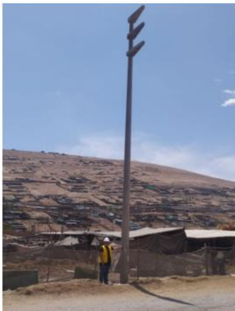
FOTO N° 26 VISTA DE POSTE SIN CONEXIÓN A ELECTRICIDAD EN ZONA MEDIANAMENTE ALEJADA – QUEBRADA CARAMOLLE – TACNA 2022
