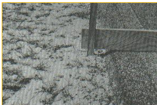
Figura 53: “Desnivel carril / berma de Severidad Baja”
