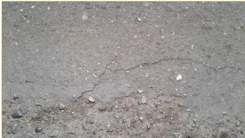
Figura 99: Grietas longitudinales y transversales de Severidad Baja
