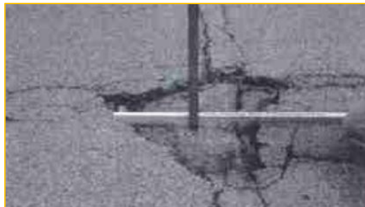
Figura 64: “Hueco de Severidad Media”
