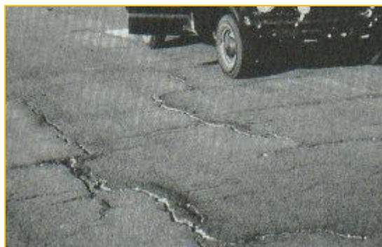
Figura 37: “Fisura en Bloque de Severidad Alta”
