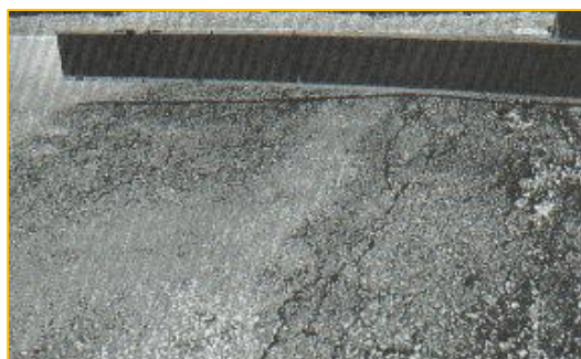
Figura 40: “Abultamientos y hundimientos de Severidad Alta”
