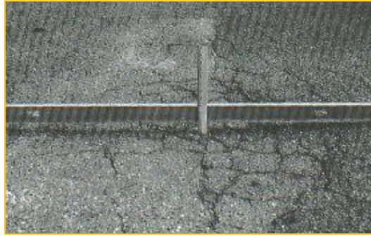
Figura 45: "Depresión de Severidad Media"
