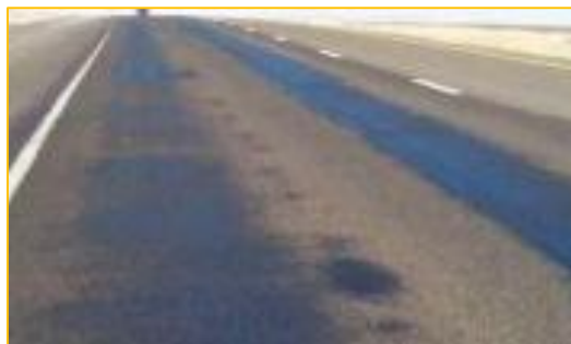
Figura 33: “Exudación de Severidad Media”
