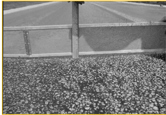
Figura 70: “Ahuellamiento de Severidad Media”
