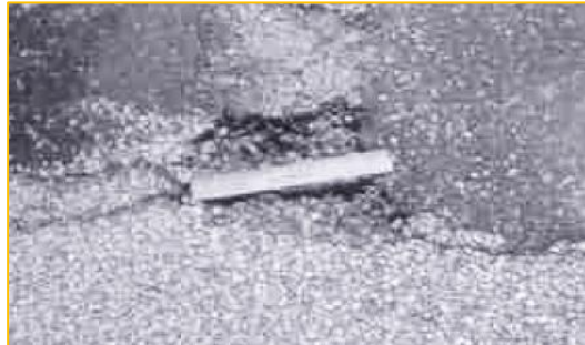
Figura 63: “Hueco de Severidad Baja”
