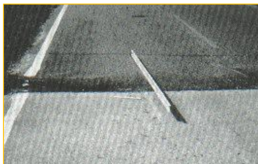
Figura 74: “Desplazamiento de Severidad Alta”
