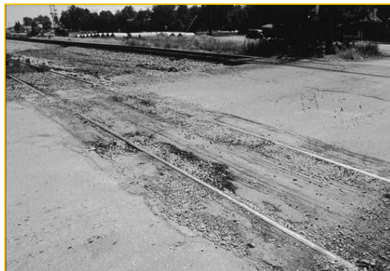
Figura 68: “Cruce de Vía Férrea de Severidad Alta”
