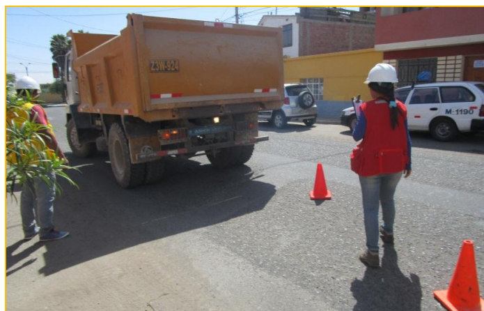
Figura 112: Posicionamiento del Camión - Carril Izquierdo.
