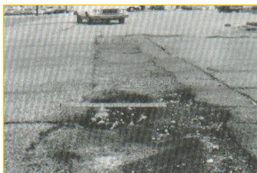
Figura 61: “Parcheo de Severidad Alta”
