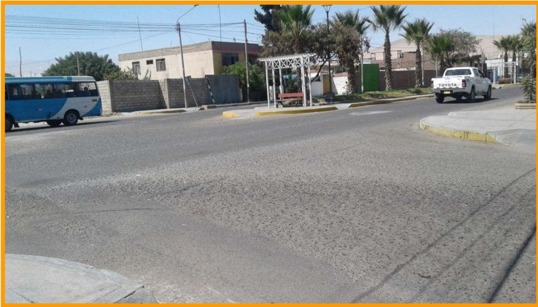
Figura 3: Desgaste de la Avenida Jorge Chávez.
