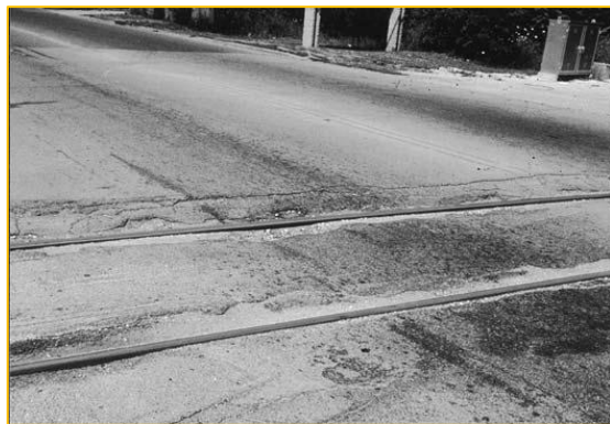
Figura 67: “Cruce de Vía Férrea de Severidad Media”
