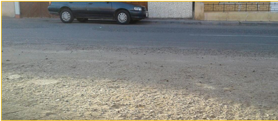
Figura 100: Desprendimiento de Agregados de severidad Baja
