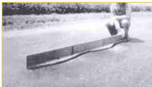
Figura 43: “Corrugación de Alta Severidad”
