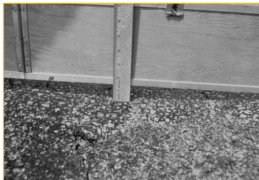
Figura 71: “Ahuellamiento de Severidad Alta”
