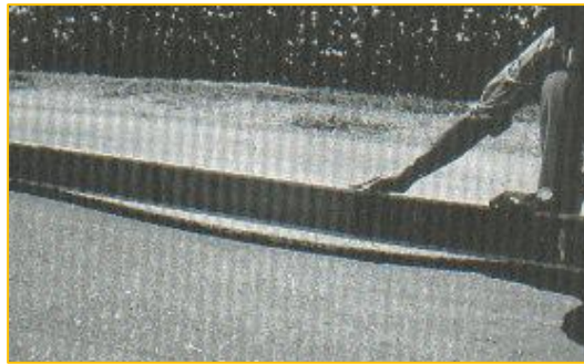
Figura 46: "Depresión de Alta Severidad"
