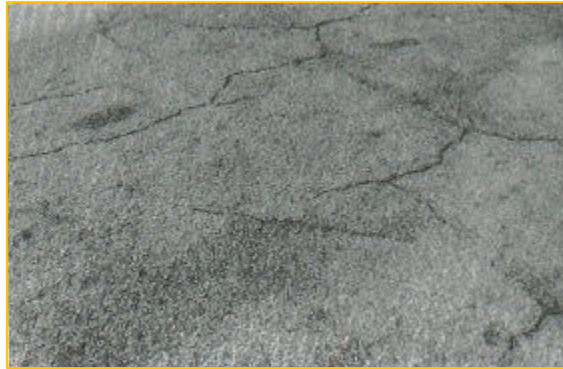
Figura 35: “Fisura en Bloque de Severidad Baja”
