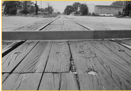
Figura 66: “Cruce de Vía Férrea de Baja Severidad”
