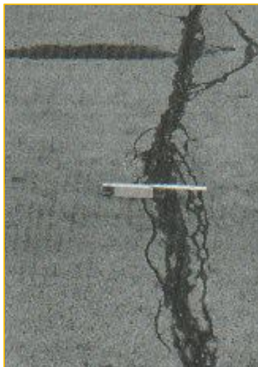
Figura 52: “Grietas de Reflexión de Junta de Severidad Alta”
