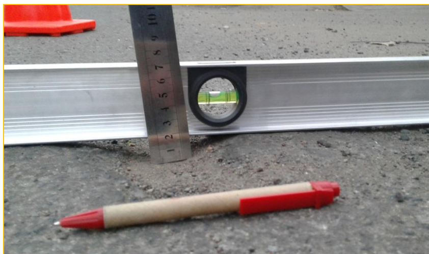
Figura 101: Hueco de Severidad Media
