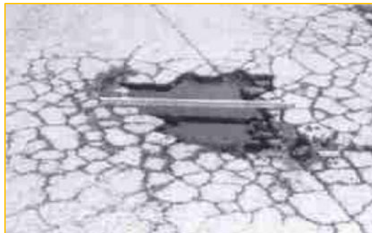
Figura 65: “Hueco de Severidad Alta”
