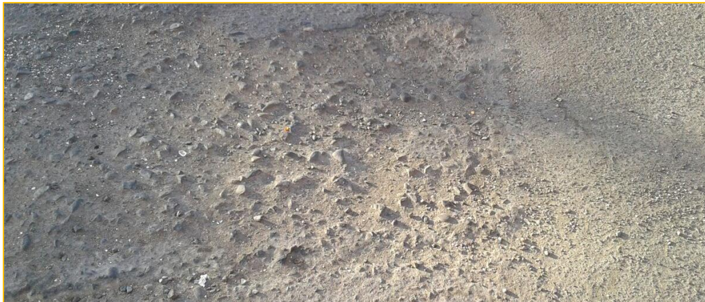
Figura 97: Desprendimiento de Agregados de severidad Media
