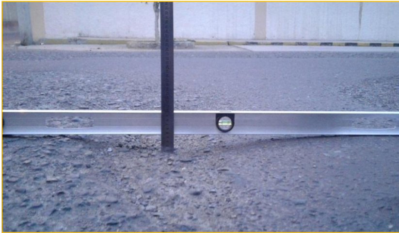
Figura 104: Depresión de Severidad Alta.
