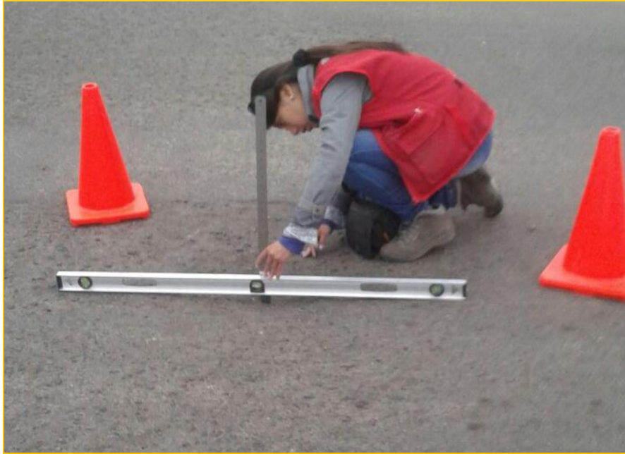
Figura 98: Ahuellamiento de Severidad Media
