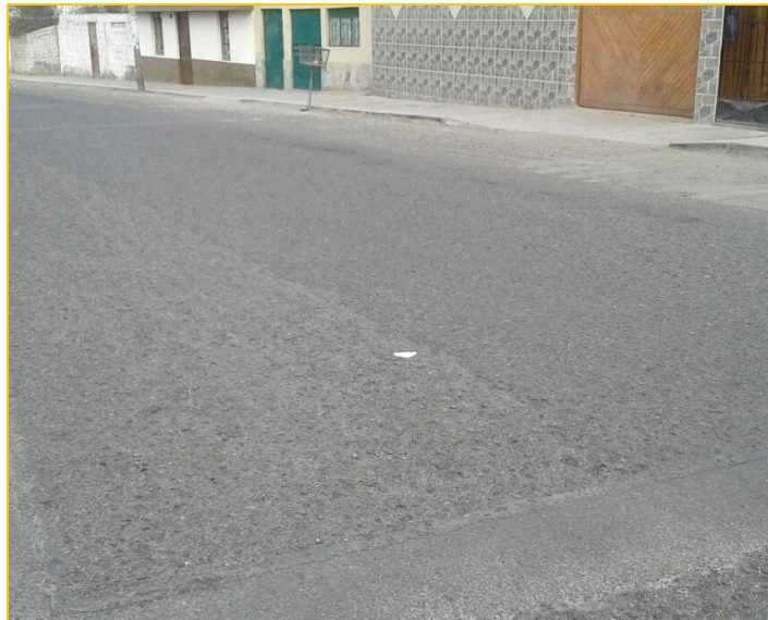
Figura 93: Ahuellamiento en severidad Baja
