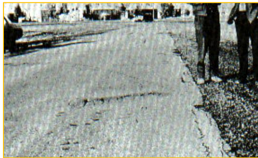
Figura 39: “Abultamientos y hundimientos de Severidad Media”
