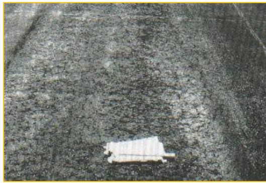
Figura 80: “Disgregación de Severidad Media”
