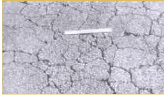
Figura 31: “Piel de Cocodrilo de Alta Severidad”
