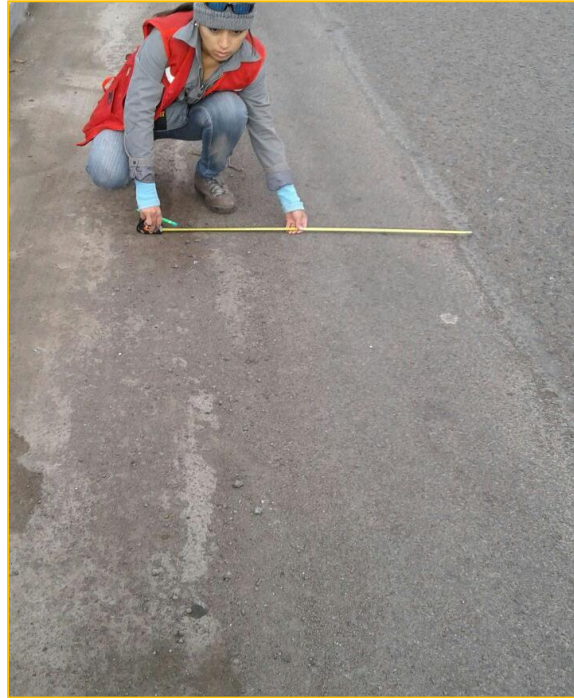
Figura 92: Toma de medidas de Un Parche de severidad Baja
