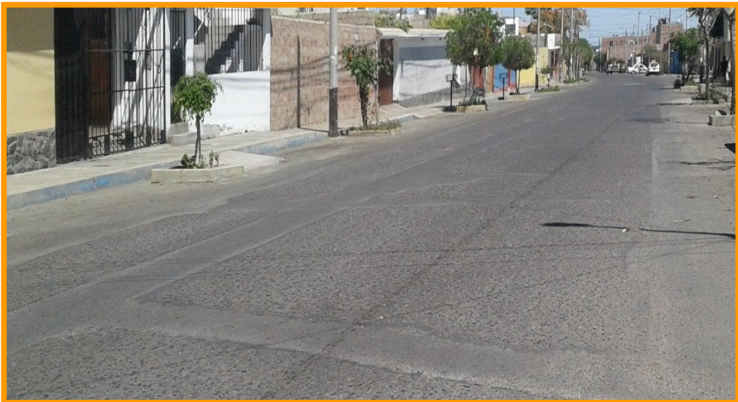
Figura 6: Parcheo de Agua Y Desagüe
