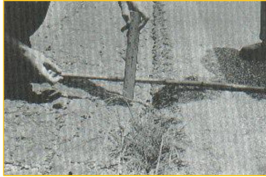
Figura 54: “Desnivel carril / berma de Severidad Media”
