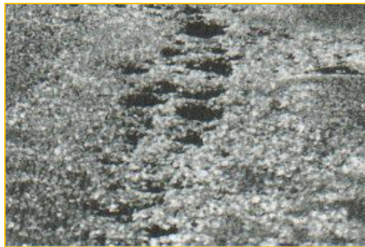
Figura 81: “Disgregación de Severidad Alta”
