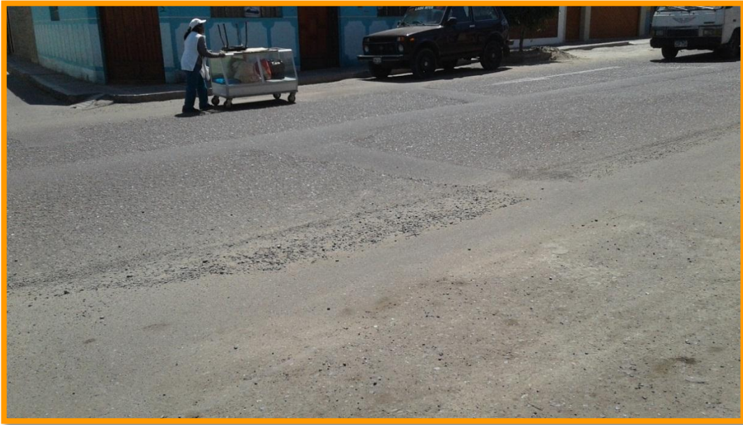
Figura 5: Desprendimiento de agregados
