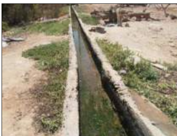
Figura 9: Canal de riego denominado Rejilla A - sector Bajo Caplina Fuente: Propio
