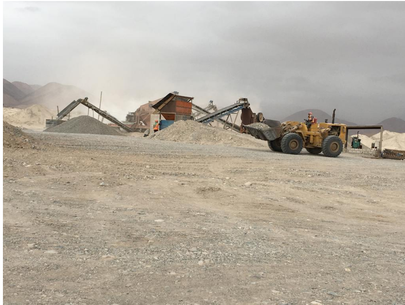
Fotografía 6 Por ultimo el material zarandeado es trasladado a la Chancadora, por medio de un cargador frontal.
