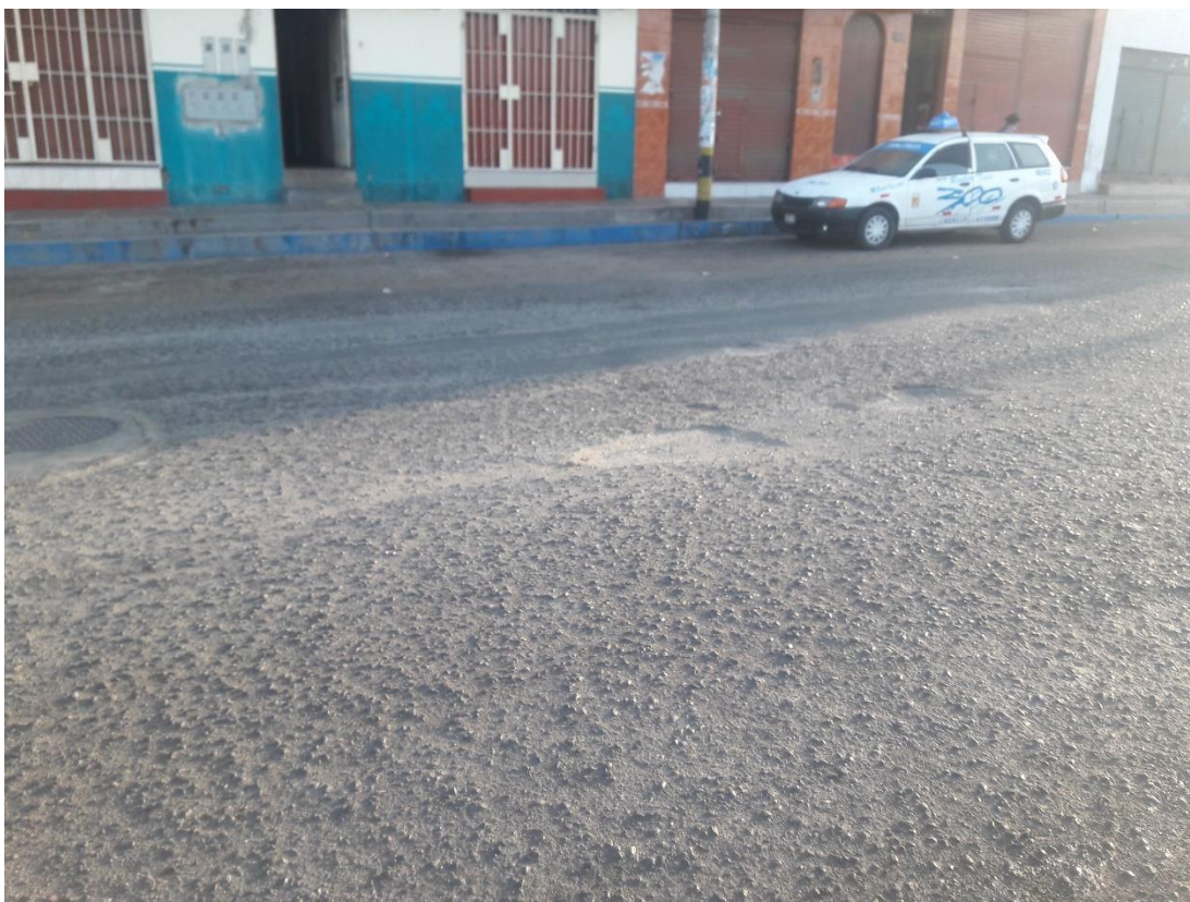
Fotografía 12. Se observa un alto desgaste de la superficie.
