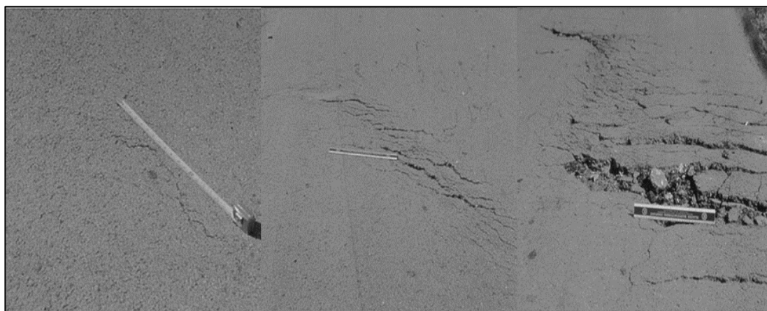
Fig. 03-17 Grieta parabólica de baja, media y alta severidad.
