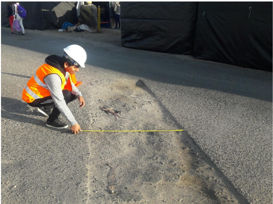
Fotografía 22. Medición del área para el tipo de falla de Parcheo para el PCI.
