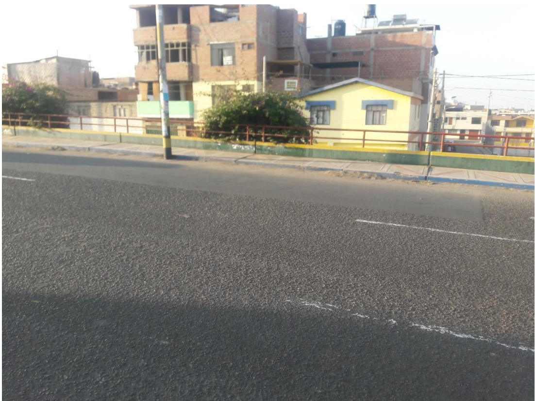
Fotografía 14. Parcheo y desgaste de superficie en la avenida Jorge Basadre Grohmann.
