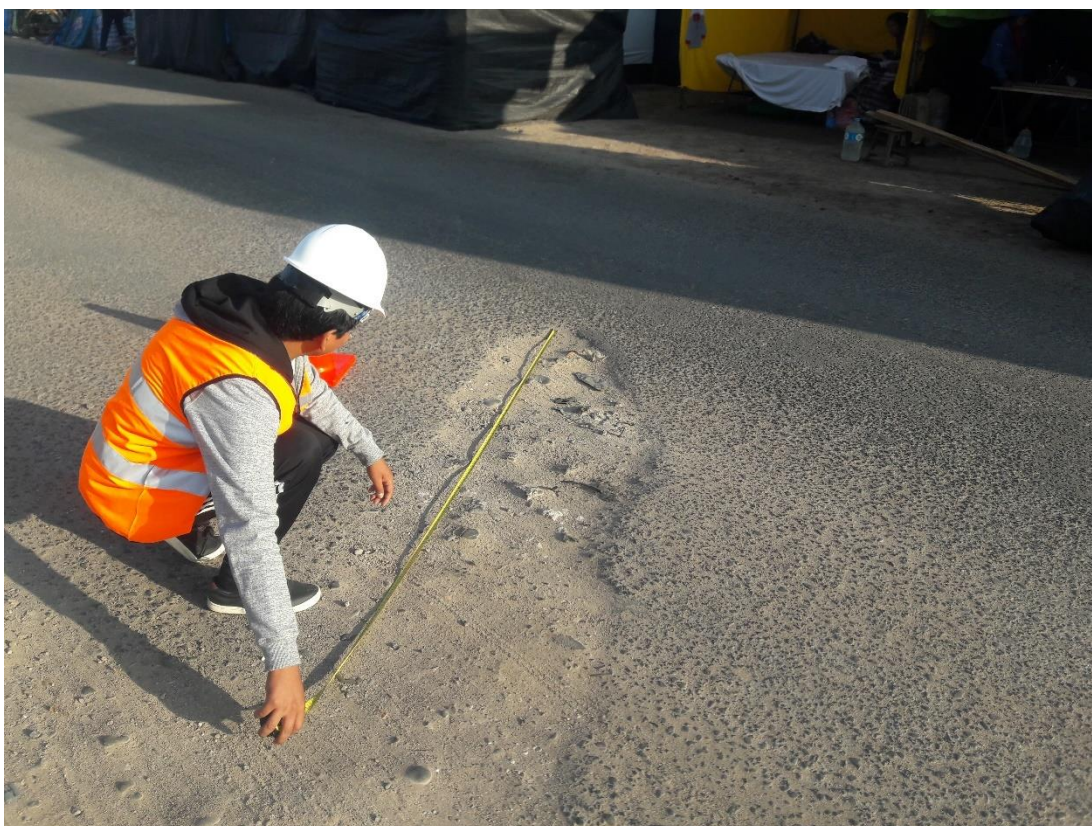
Fotografía 24. Medición del área para el tipo de falla de Parqueo para el PCI.
