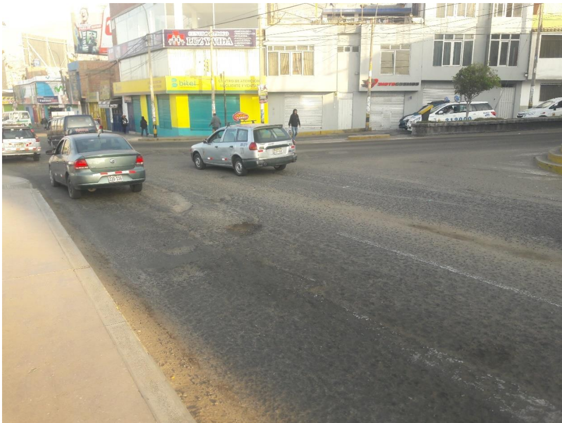
Fotografía 11. Presencia de huecos y desprendimiento de agregados en la dirección este a oeste.
