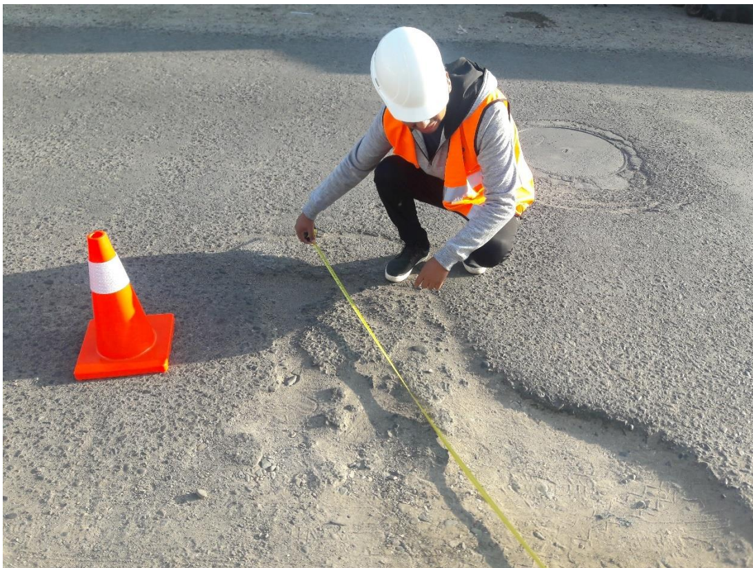
Fotografía 23. Medición del área para el tipo de falla de Parqueo para el PCI.
