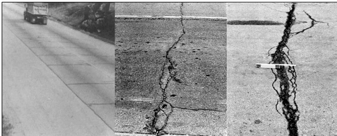
Fig. 03-8 Grieta de reflexión de junta de baja, media y alta severidad.
