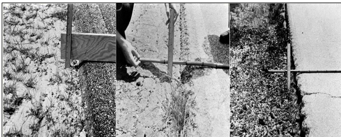
Fig. 03-9 Desnivel carril berma de baja, media y alta severidad.
