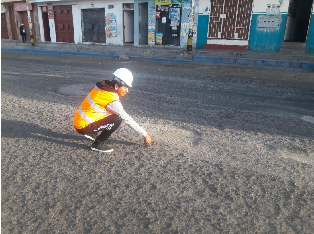
Fotografía 13. Presencia de huecos y un alto desgaste de la superficie.
