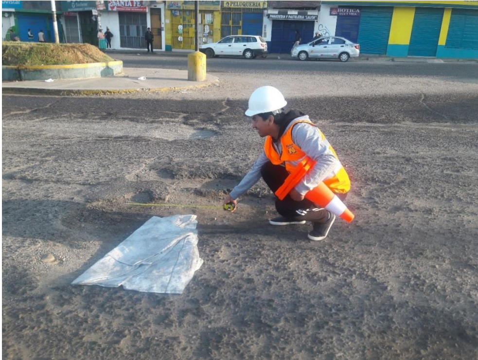
Fotografía 9. Huecos, desprendimiento de agregados al frente del grifo municipal de Ciudad Nueva.
