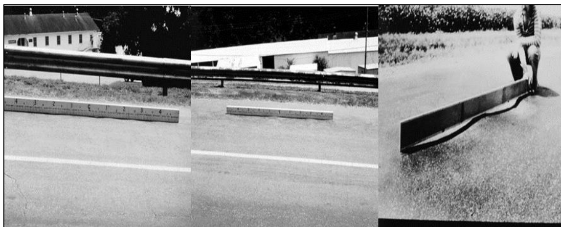
Fig. 03-5 Corrugación de baja, media y alta severidad.
