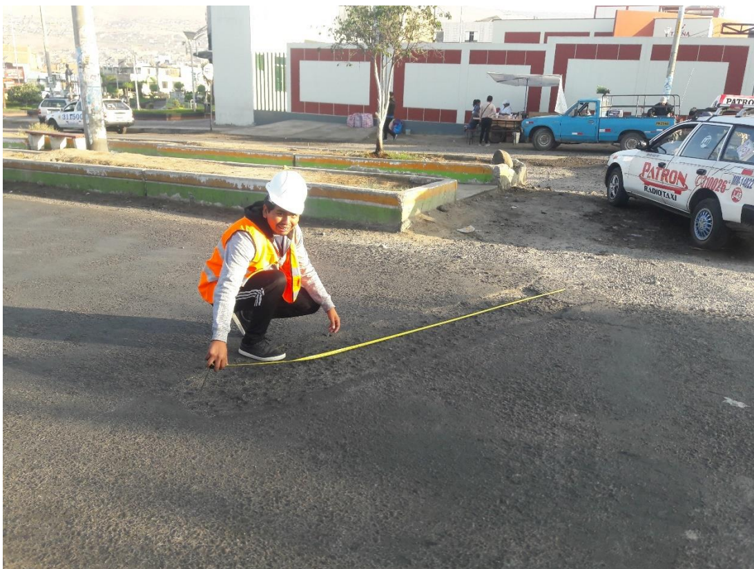
Fotografía 20. Medición del área para el tipo de falla de Parcheo para el PCI.
