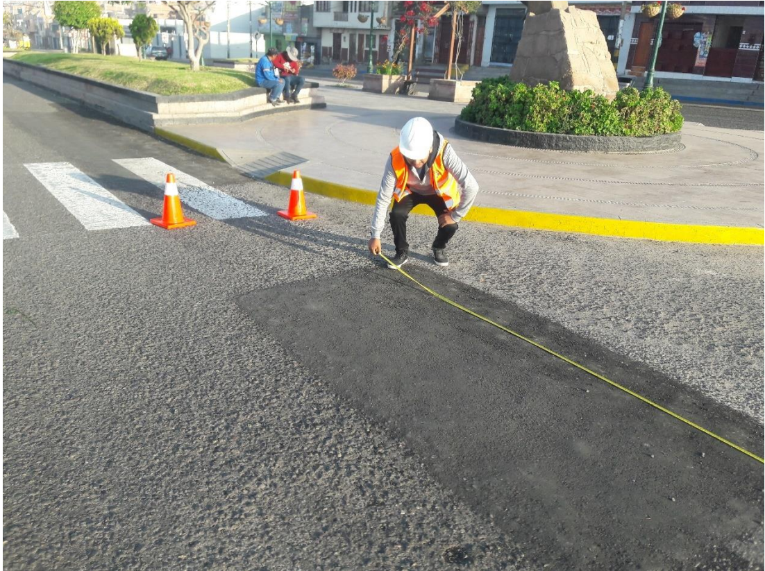
Fotografía 17. Medición del área para el tipo de falla de Parcheo para el PCI.
