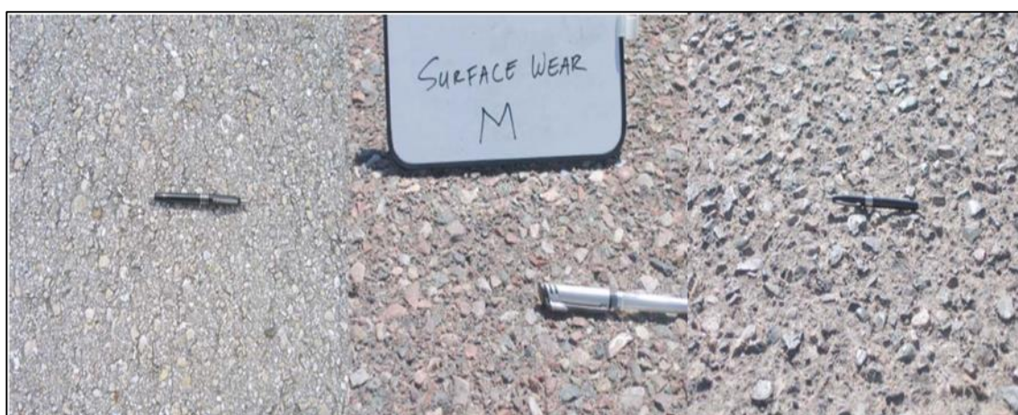
Fig. 03-19 Desprendimiento de agregados de baja, media y alta densidad.
