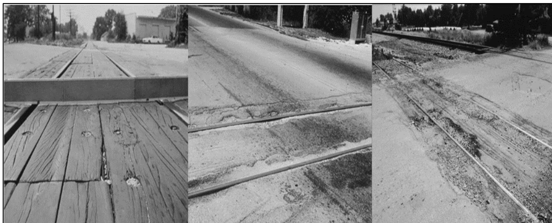
Fig. 03-14 Cruce de vía férrea de baja, media y alta severidad.
