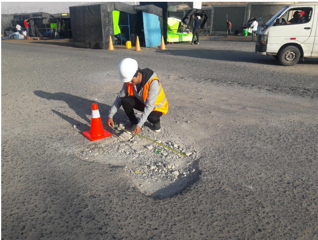
Fotografía 25. Medición del área para el tipo de falla de Hueco para el PCI.
