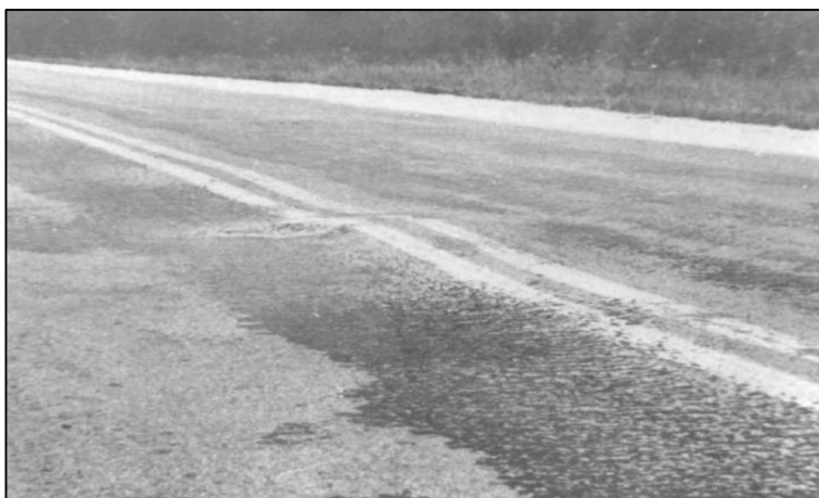
Fig. 03-18 Hinchamiento de severidad alta.
