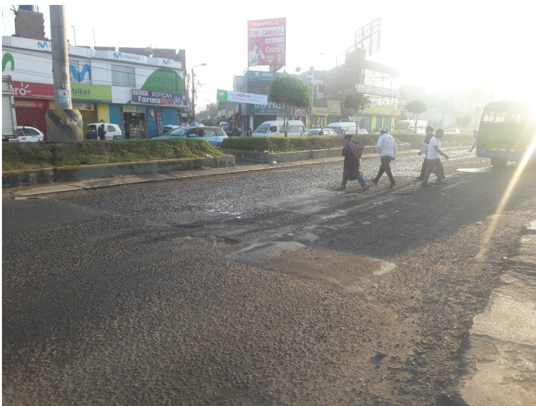
Fotografía 8. Mal estado de la vía al frente del grifo municipal de Ciudad Nueva.
