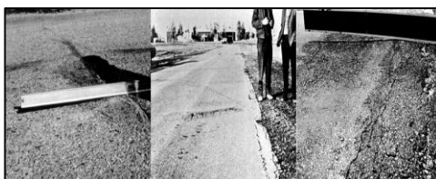
Fig. 03-4 Abultamientos y hundimientos de baja, media y alta severidad.
