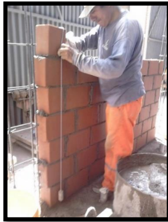
Figura 3.11. Asentado y aplome de unidad de albañilería blocker II con nivel y plomada; aparejo de unidades de albañilería tipo sogá.
