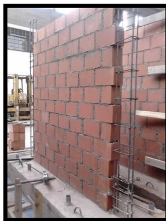
Figura 3.12. Dentado de 5cm. del muro para amarre de columnas de confinamiento con zunchos de 4mm.
