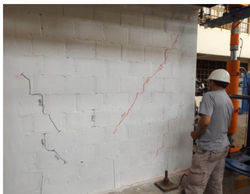
Foto 5. Aumento de grietas diagonales para una distorsión 1/1100.
