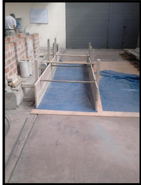
Figura 16. Se coloca un plástico y un triplay para evitar la adherencia al suelo de laboratorio, al mismo tiempo se va armando el encofrado de la base.
