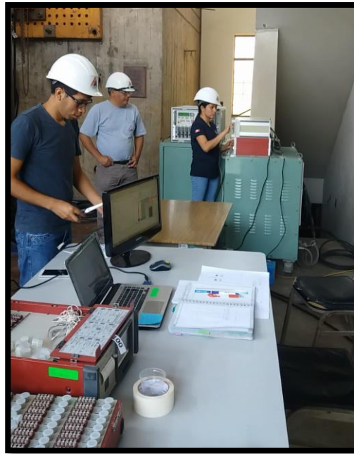
Figura 3.42. Sistema de instrumentación instalado.
