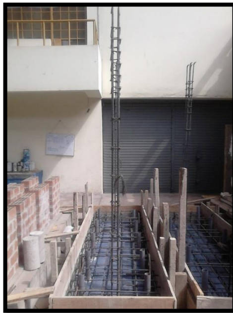
Figura 3.9. Habilitación de acero para columnas de confinamiento anclado a la cimentación y enconfrado de base de muro.
