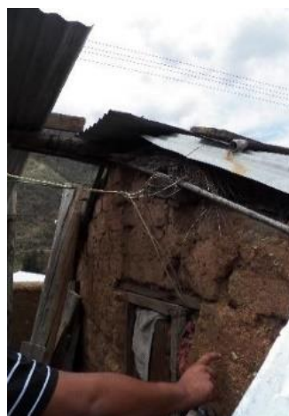
Revoques de muros en mal estado
