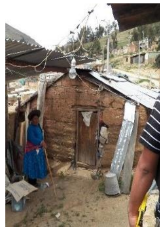
Viviendas en estado de colapso
