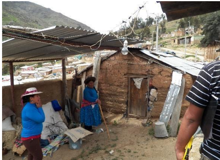
(Vivienda colapsada - foto visita de campo -2017)
