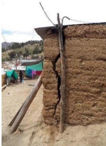
Apertura y colapso de muros
