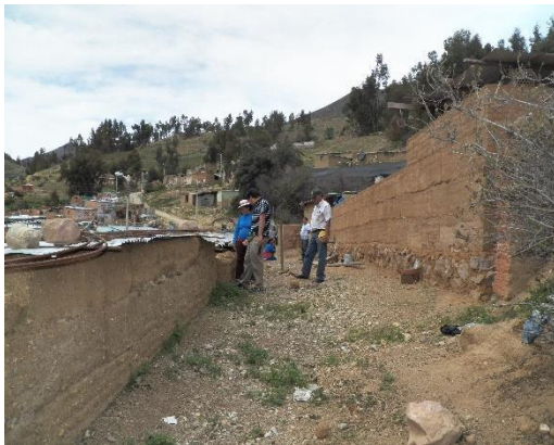
Mal estado de muros perimétricos
