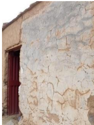
Muro sin cobertura aislante externa
