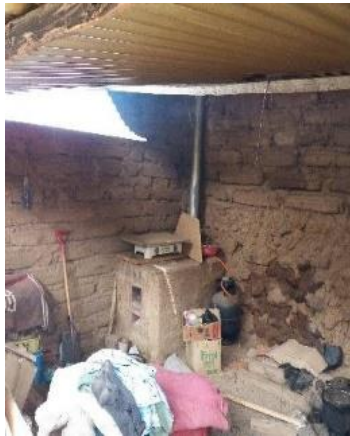
Ambientes con riesgo de desplome
