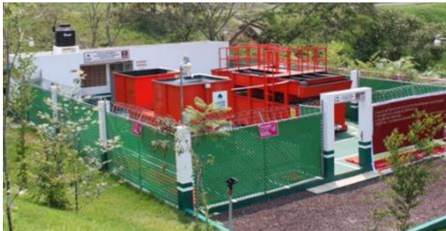
Figura 13: Planta de Tratamiento de Aguas Negras y Residuales.
