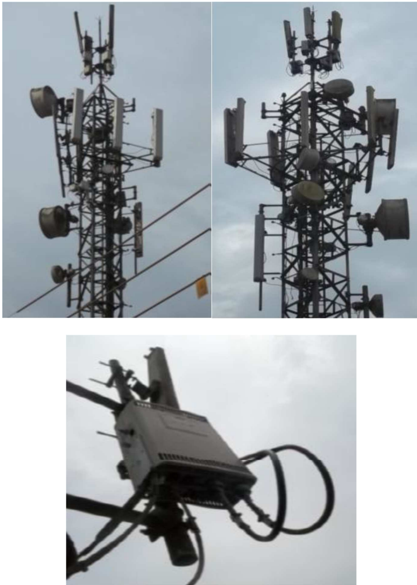
Foto 1: Montaje en torre existente para las antenas, las RRUs
