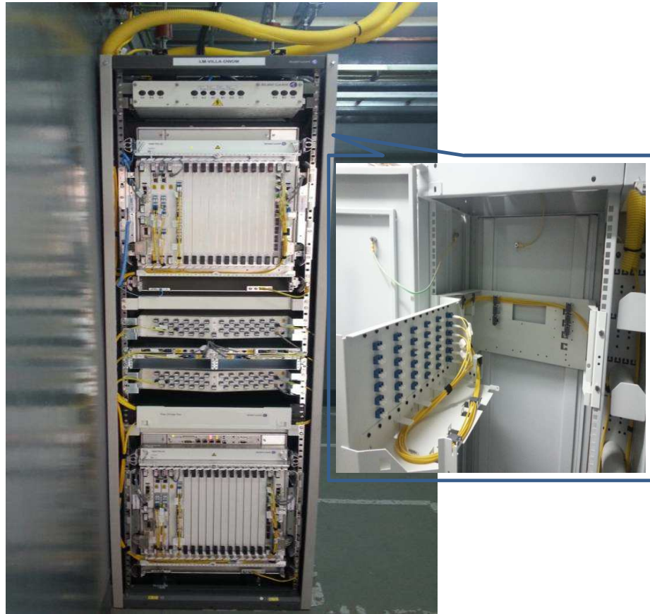
Foto 11: Equipo DWDM y patch panel
