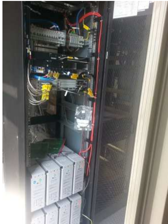
Foto 6: BBU+DCDU instalado en el gabinete de transmisión
