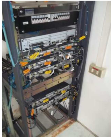
Foto 2: Gabinete de transmisión instalado
