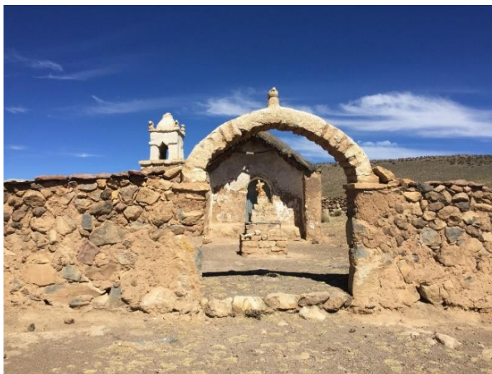
Figura 16. Deterioro del Patrimonio Inmueble
