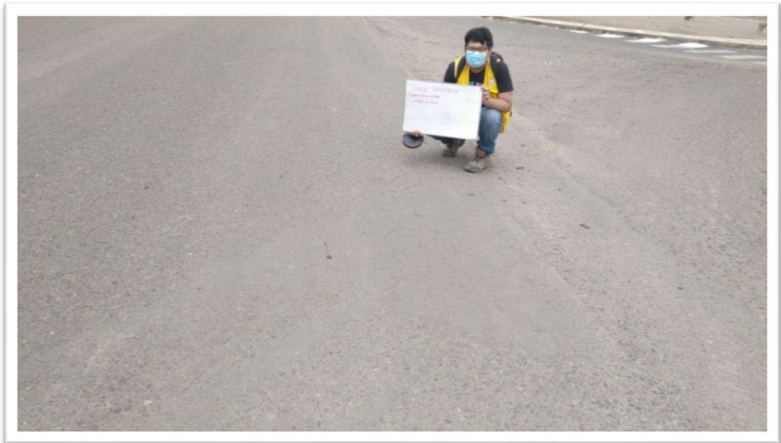
Meteorización del pavimento y último tramo de PCI analizado.
