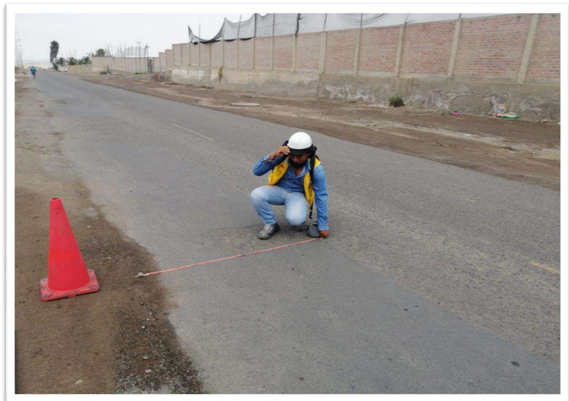
Parche severidad media.
