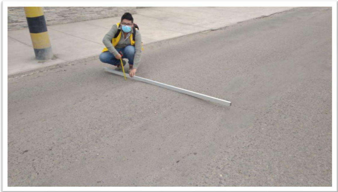
Abultamiento o hundimiento severidad baja
