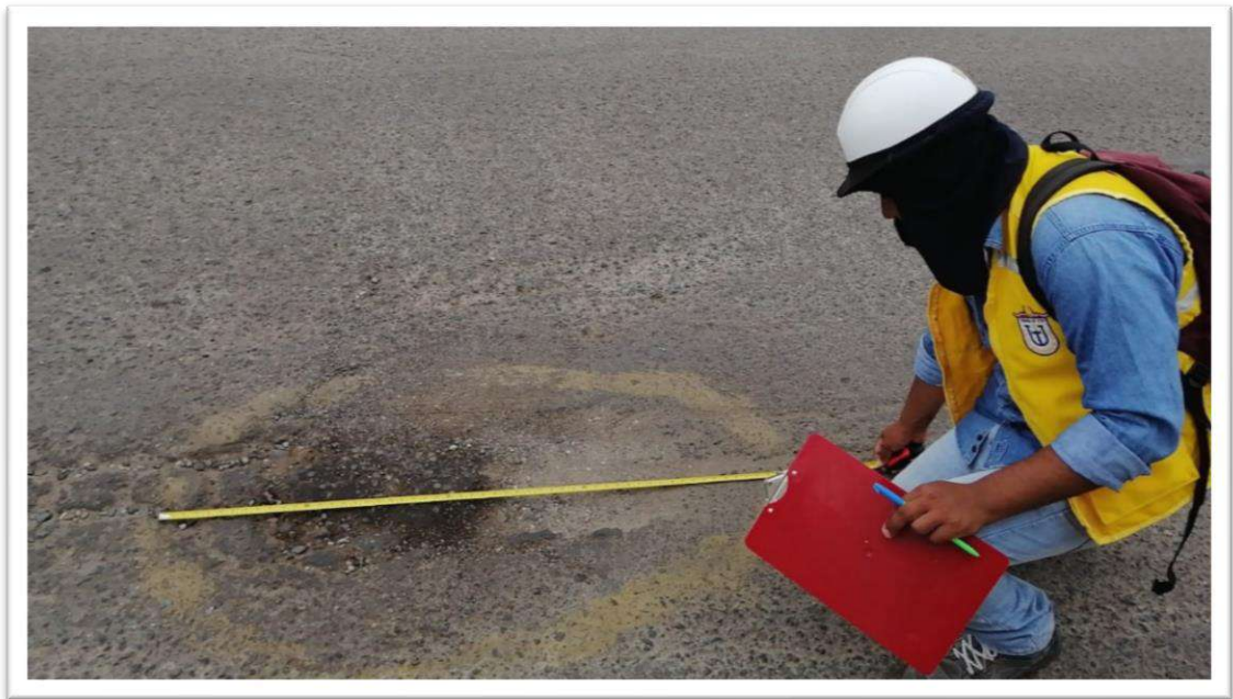
Hueco o bache de severidad media.
