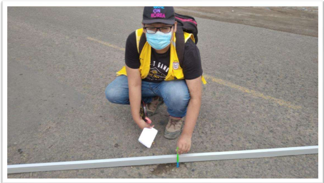
Hueco o bache severidad baja.
