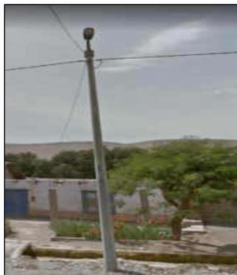
Figura 151: Poste de Iluminación Fuente: Elaboración Propia
