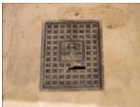
Figura 142: Caja de Registro de Agua
