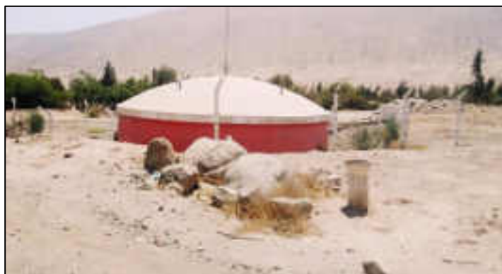
Figura 144: Reservorio de Agua
