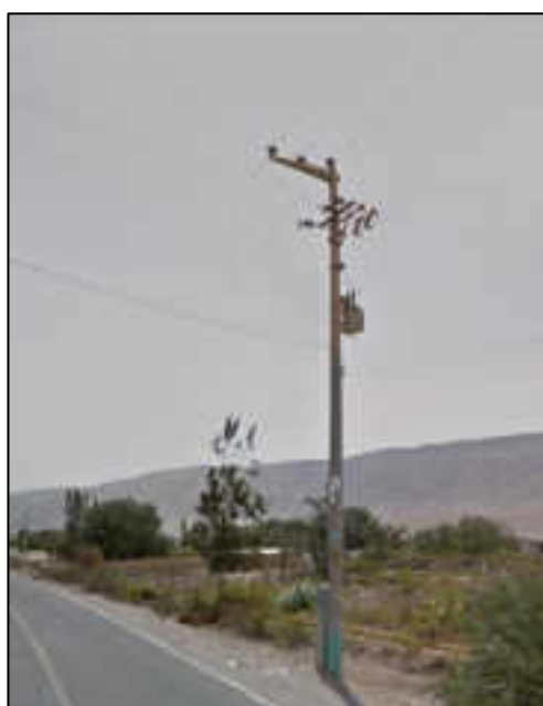
Figura 148: Poste de Electricidad
