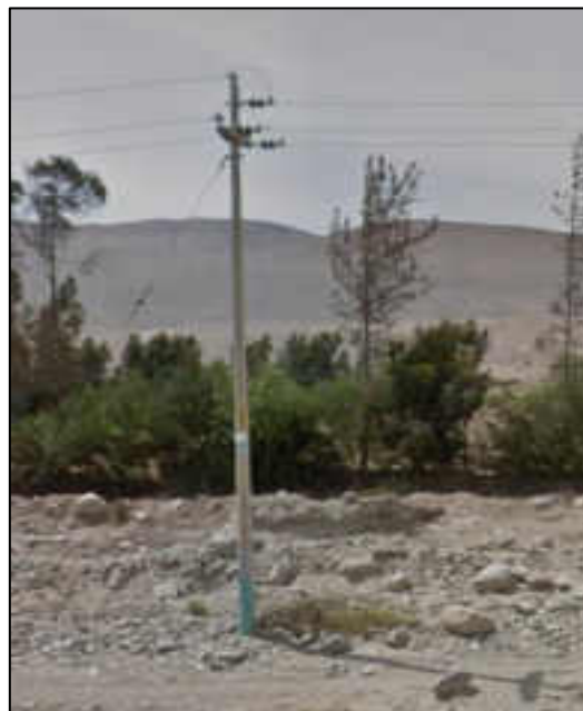
Figura 149: Poste de Electricidad
