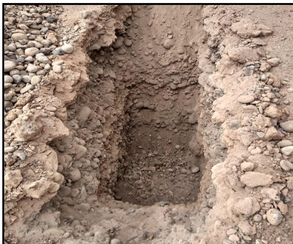
Fotografía 22: Producto de la excavación en la Calicata C – C del sector 12 San Antonio.
