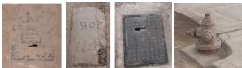
Figura 107. Fotografías de medidores y buzón de agua de la zona. Fuente: Fotografías tomadas por las autoras.
