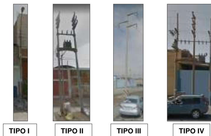
Figura 111. Tipo de postes de la zona.
