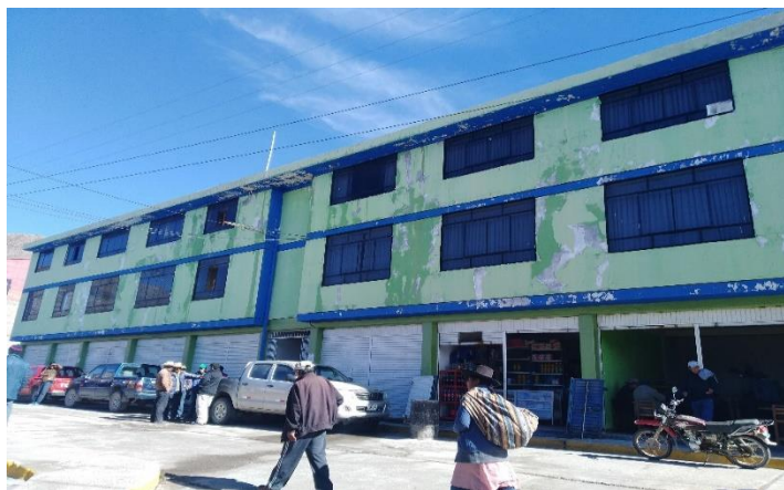
Figura 63: Hotel Municipal de la Provincia de Candarave se aprecia las deficientes condiciones que se encuentra la infraestructura
