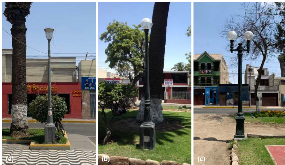
Figura 79: En la figura (a) se observa la luminaria tipo L-01, (b) luminaria L-02 y (c) la luminaria tipo L-03.
