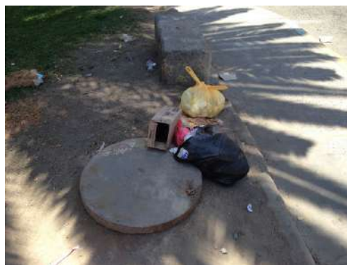
Figura 86: Figura de acumulación de basura al ingreso del A.U.M.
