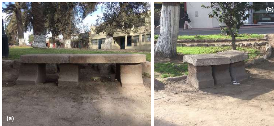
Figura 81: En las figuras (a) y (b) se observan las bancas correspondientes al Ambiente Urbano Monumental, así como su deterioro.
