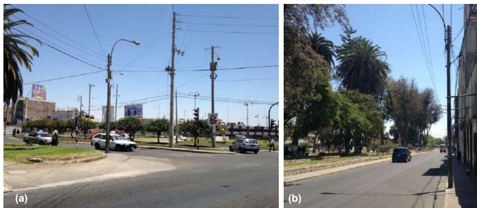
Figura 91: Vistas de el tipo de cableado que existe para las luminarias viales dentro del área de estudio.
