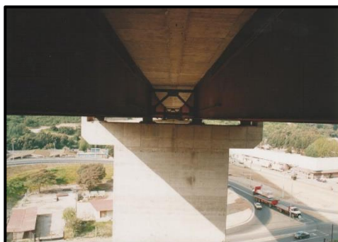
Figura N° 05: Ubicación de aisladores
