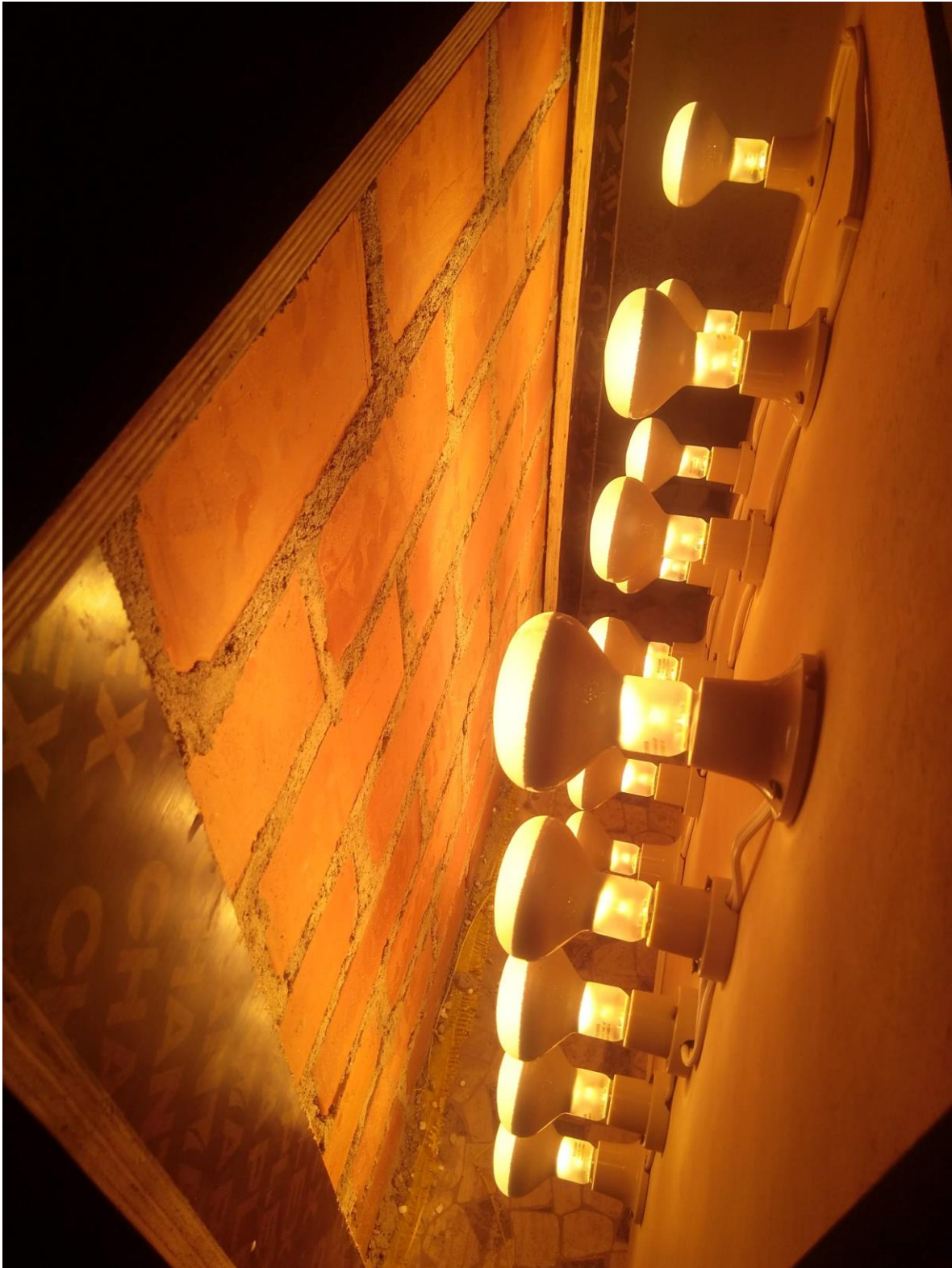
FOTO N°19: SE APRECIA EL PROCEDIMIENTO DE CALENTAMIENTO DEL MURETE SIN TARRAJEO PARA LA POSTERIOR TOMA DE DATOS.
