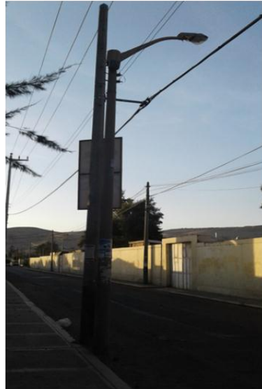
Existen 5 postes de alumbramiento público
